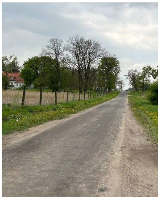
Fot. 72. Droga powiatowa w złym stanie – PGR Pilichowo.
