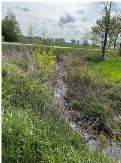
Fot. 70. Rów melioracyjny zarośnięty, w złym stanie – miejscowość Nadułki.
