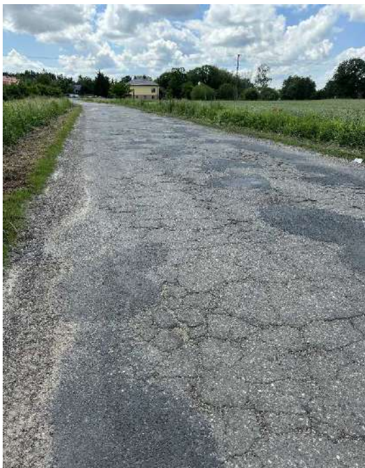
Fot. 71. Droga powiatowa w złym stanie – Blichowo.
