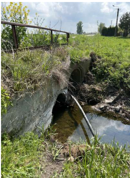
Fot. 67. Przepust na rzece Żurawianka – miejscowość Szasty.
